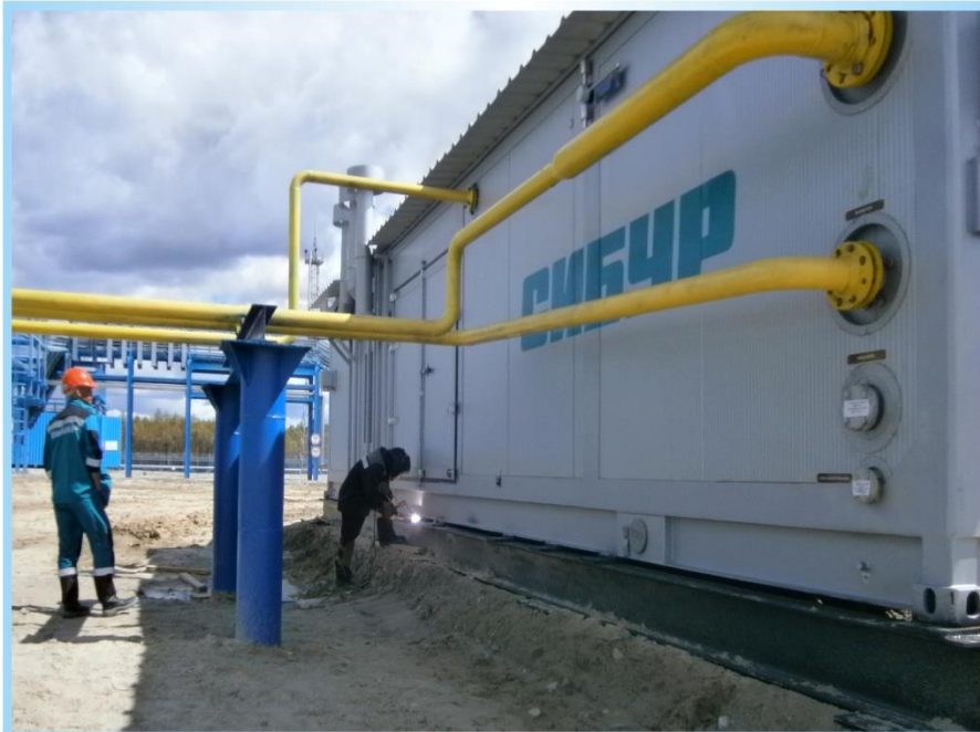
Установка станции СГП2В 55-55-8/11-17
