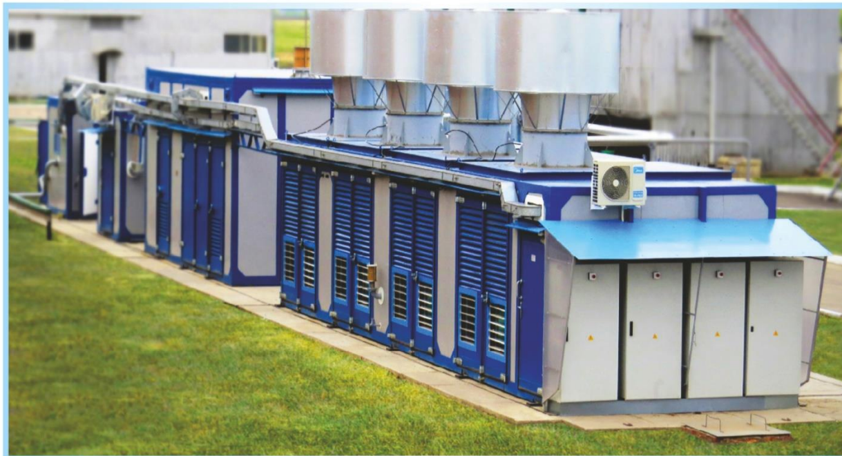
Азотная станция ААВН-40/25 У1 У1
