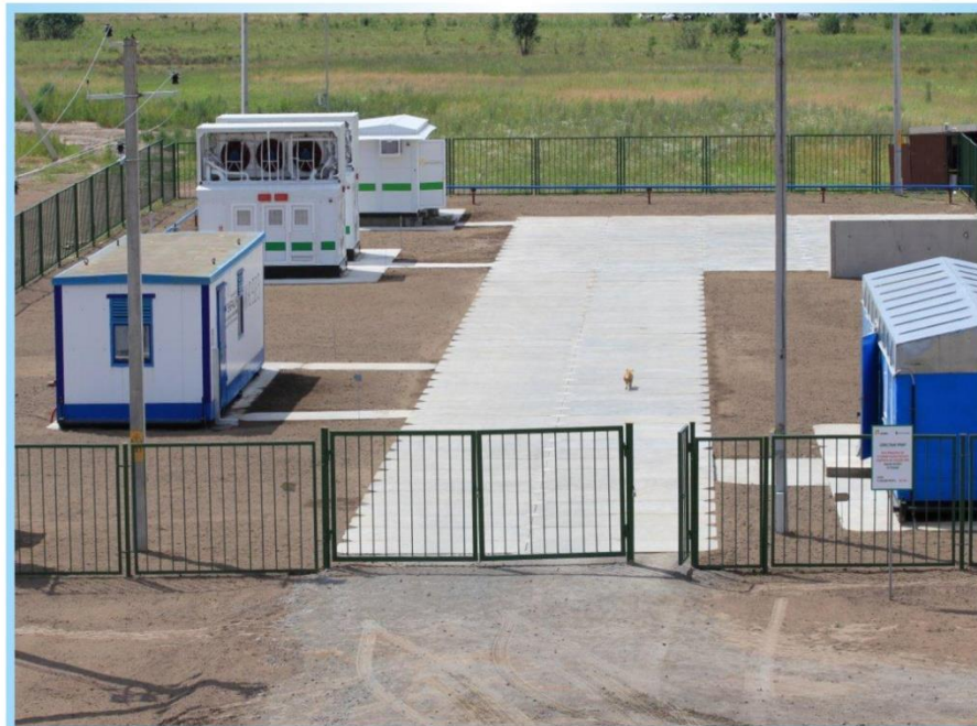
БКУ 20/35 У1 установлена на площадке скважины
